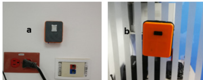
Figura 4. Dispositivos instalados: sala 7 (a) y alarma (b).
