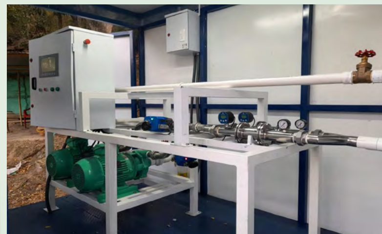
Figura 3. Aspecto del sistema instalado In situ.
